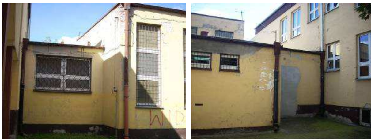
Rysunek 7 widok elewacji wschodniej i zachodniej łącznika do sali gimnastycznej i fragmentów elewacji sali gimnastycznej
