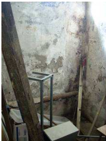
Rysunek 13 Widok wnętrza (zawilgoconej ściany) podpiwniczenia budynku Szkoły Podstawowej
