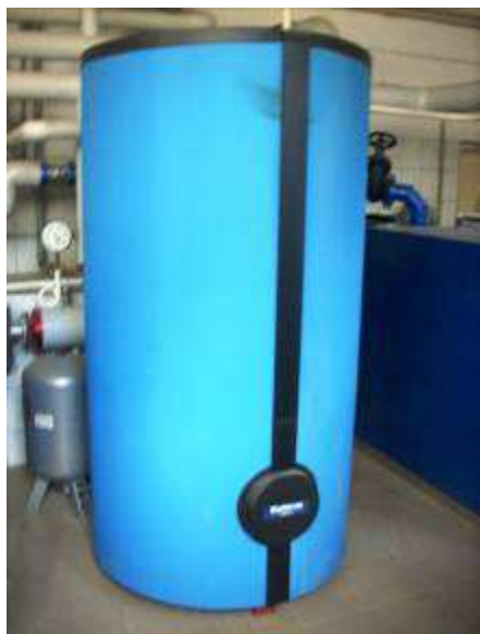
Rysunek 21 Zasobnik c.w.u. zainstalowany w kotłowni
